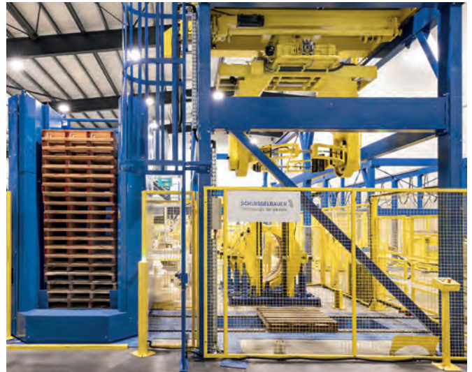
Производственные поддоны подаются в систему штабелями
